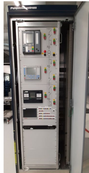
Kuva 14. Sähköverkon suoja-releistyksen oppimisympäristö
