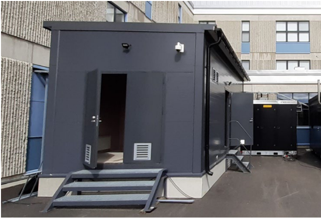
Kuva 11. 20 kV:n kojeiston ja muuntajan laitesuoja
