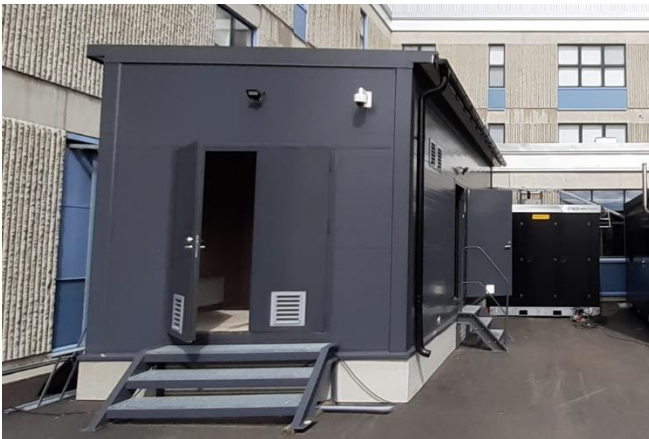
Kuva 11. 20 kV:n kojeiston ja muuntajan laitesuoja
