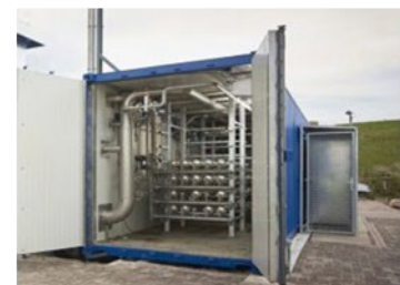
Kuva. Bright Biomethane kaasunjalostusyksikkö
