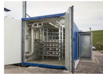
Kuva. Bright Biomethane kaasunjalostusyksikkö
