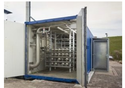
Kuva. Bright Biomethane kaasunjalostusyksikkö
