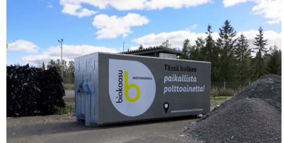
Kuva. Biovoima Oy:n kaasukontti
