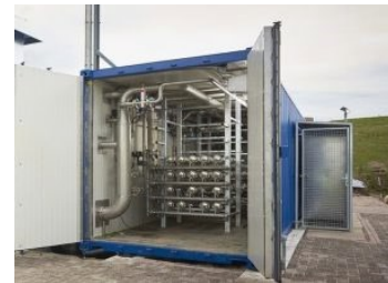
Kuva. Bright Biomethane kaasunjalostusyksikkö
