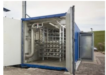
Kuva. Bright Biomethane kaasunjalostusyksikkö
