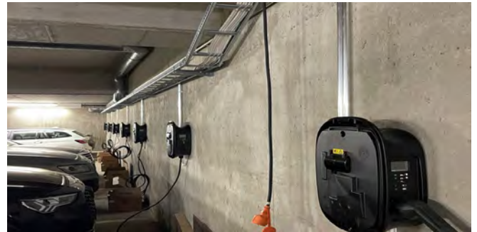
Kuva 3. Latausjärjestelmän kaapelointi pysäköintihallissa.
