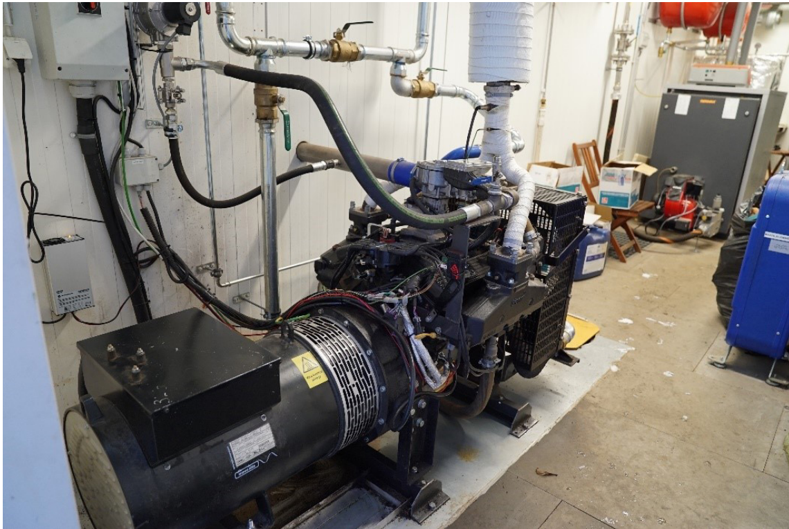
CHP-yksikkö (etualalla) ja kaasukattila (takana). Kuva, Mikko Aalto
